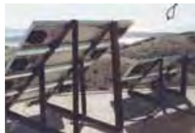
Paneles solares que alimentan de energía fotovoltaica al faro.
